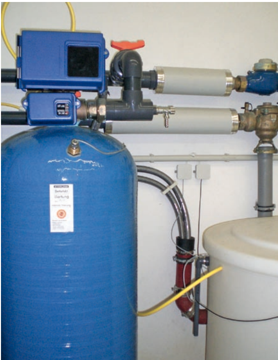
Bild 5 Stehende Wasserenthärtungsanlage mit Verbindung zum Abwassersystem
