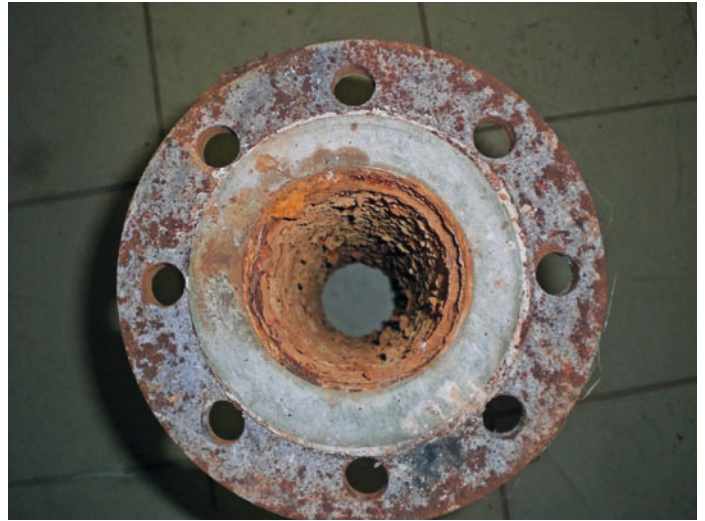
Bild 8 Korrosionsablagerungen in der Leitung
