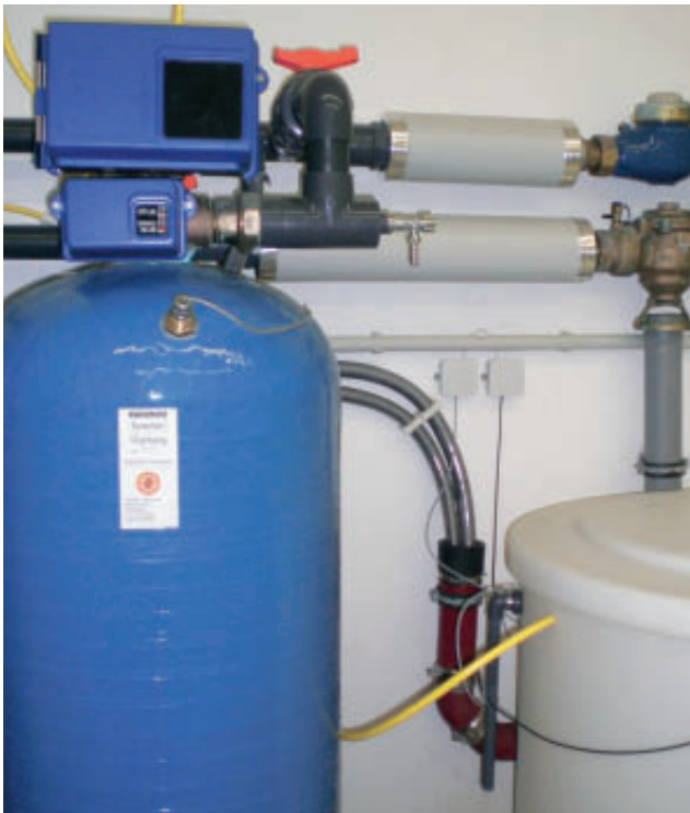
Abb. 2: „Stehende“ Wasserenthärtungsanlage mit Verbindung zum Abwassersystem
